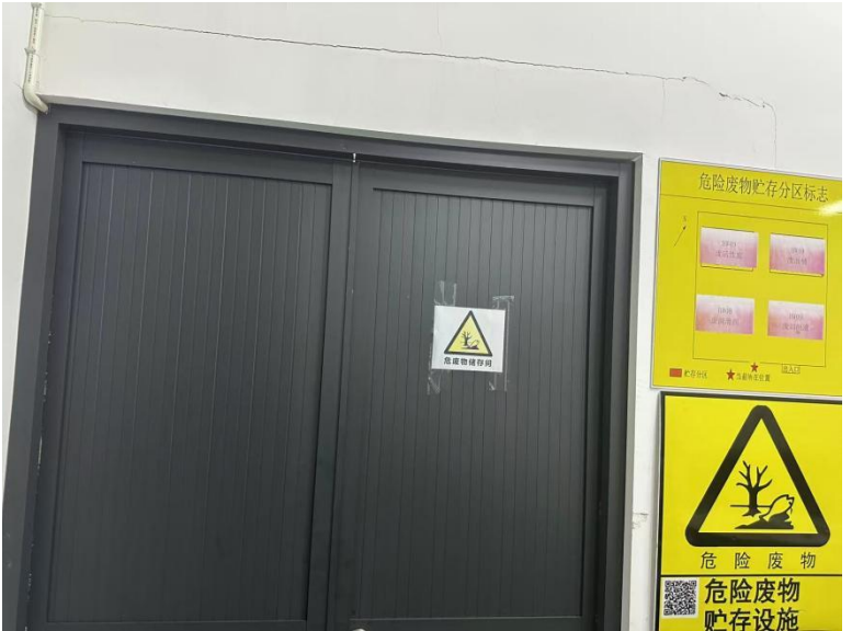
危险废物仓库
