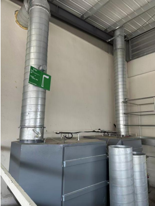
初效过滤器+二级活性炭吸附装置+DA001 排气筒
