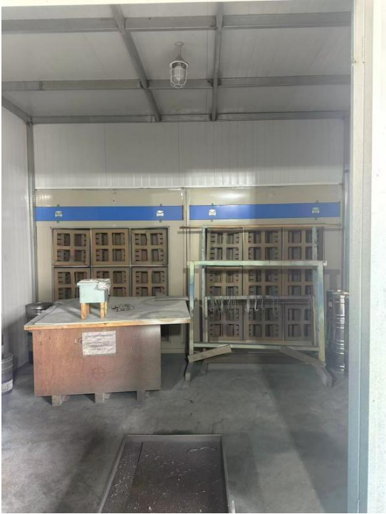
喷漆房废气收集（含干式过滤器）
