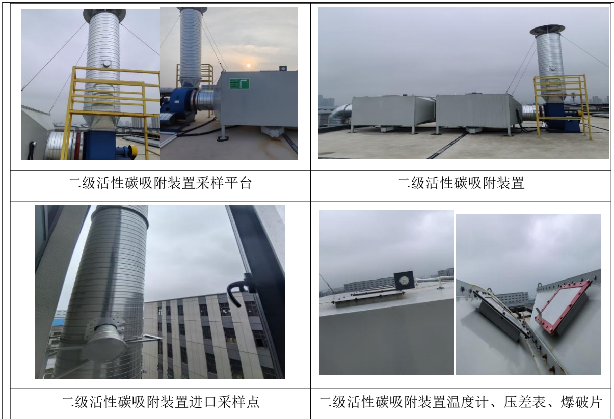
图 3-7 废气处理设施现场照片
