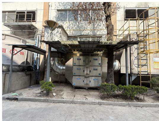
废气处理设施
