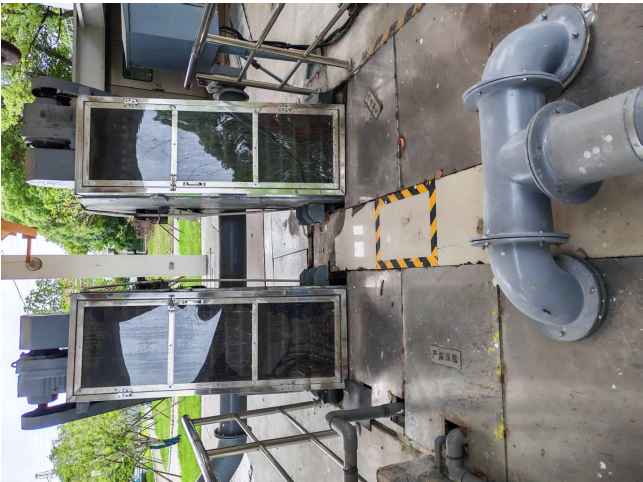
全厂全封盖收集装置
