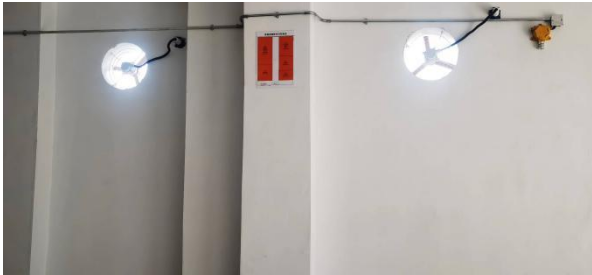
危废仓库排气扇
