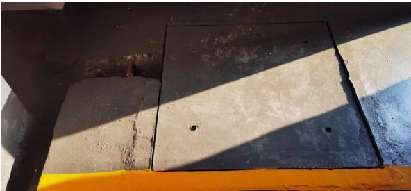
危废仓库废液收集池
