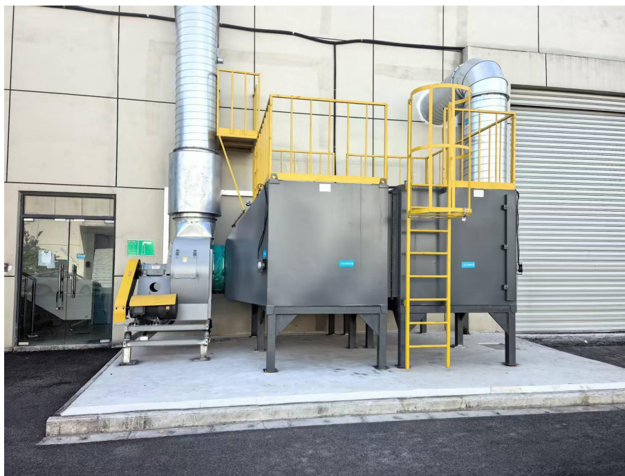
二级活性炭吸附装置+DA003 排气筒
