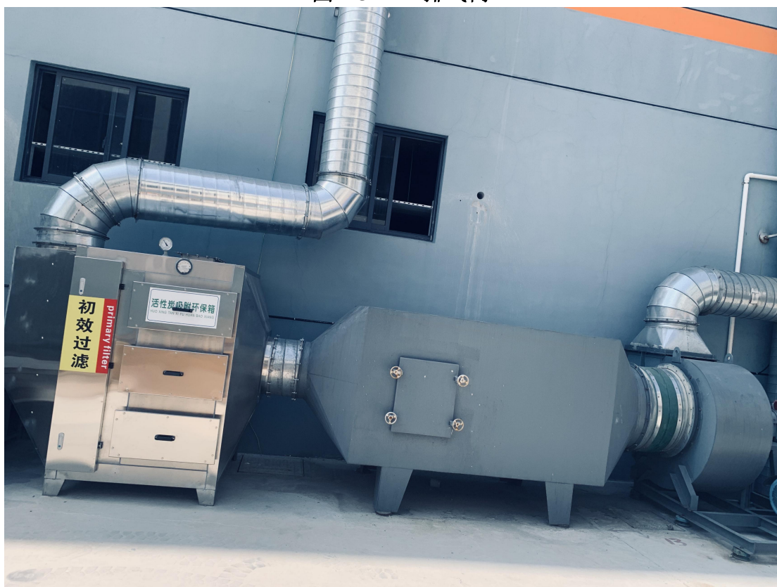
图 4-6 废气处理设施
