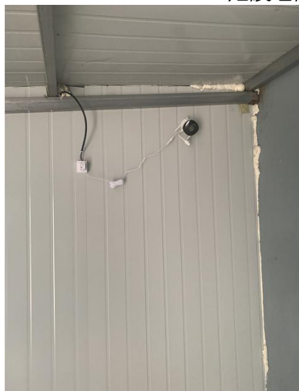
危废仓库内摄像头
