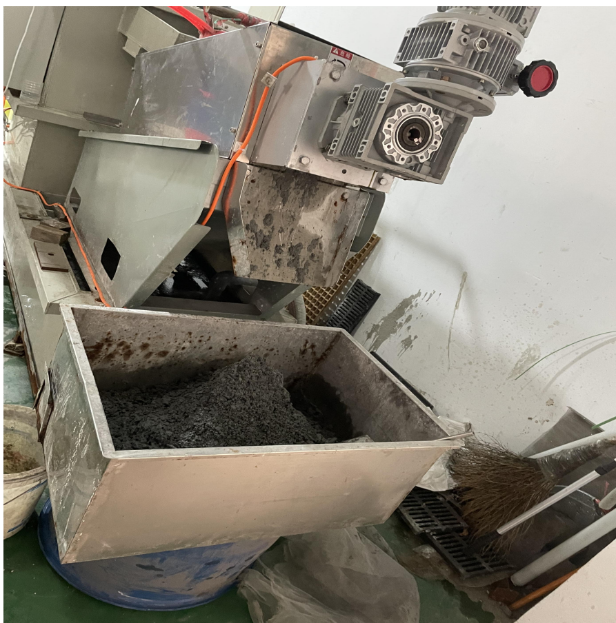
图 4-4 污水处理设备
