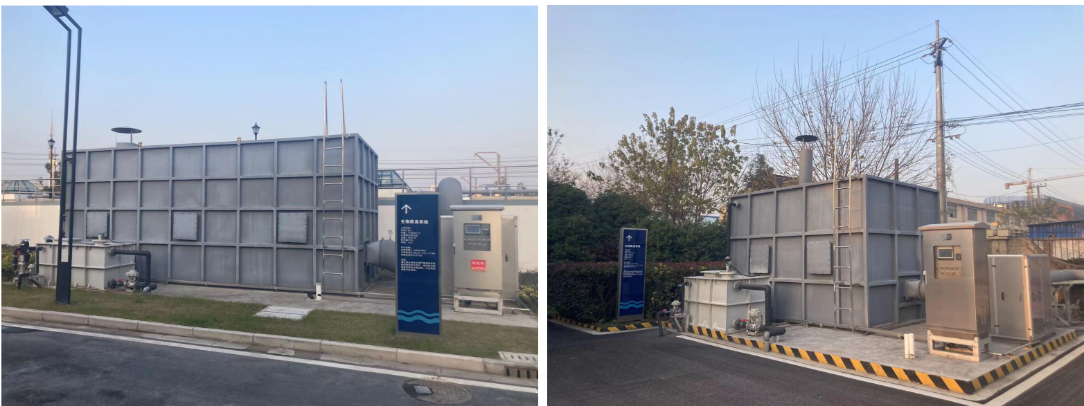
图 4-4 生物除臭装置
