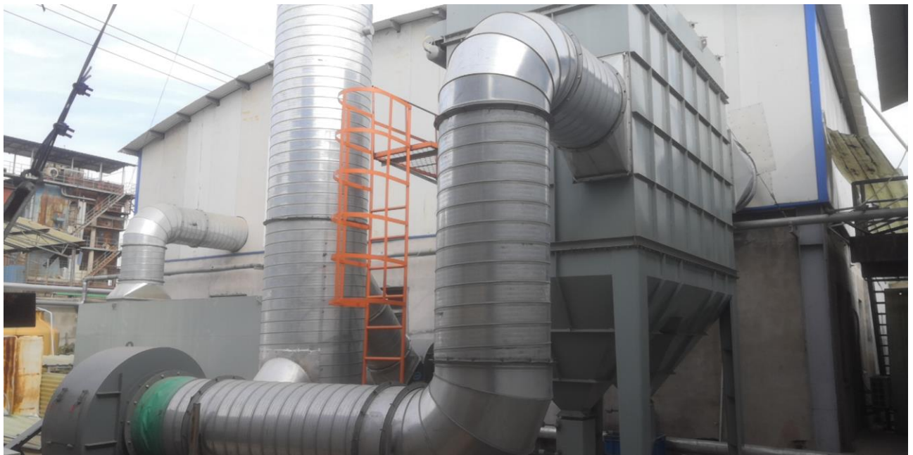
配料粉尘布袋除尘器(FQ4)
