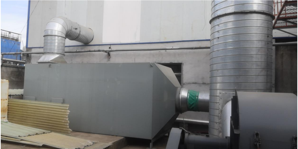
挤出废气活性炭吸附装置 (FQ4)
