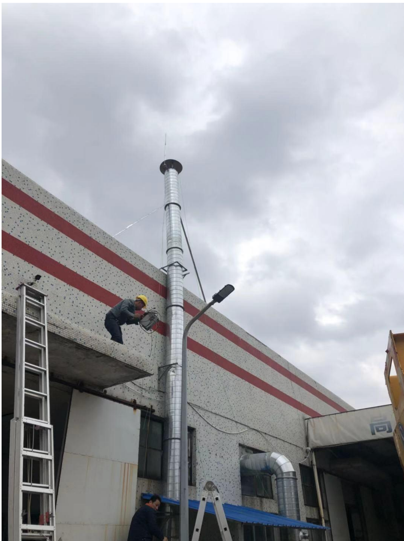
附图三：废气处理设施照片
