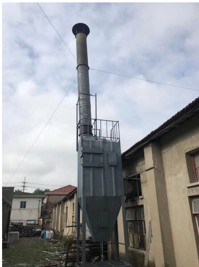
造粒废气活性炭吸附装置
