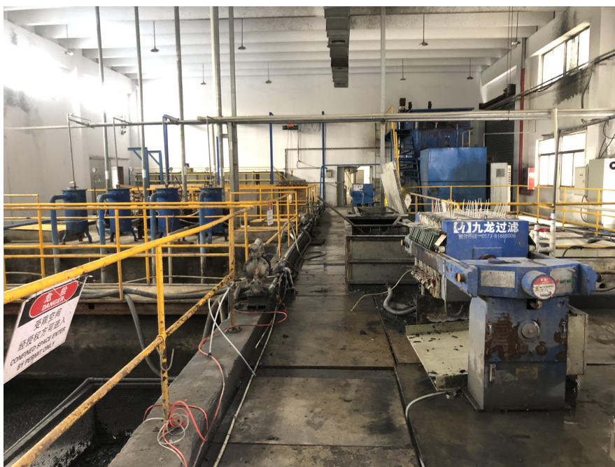
图4.3-7 废水处理车间
