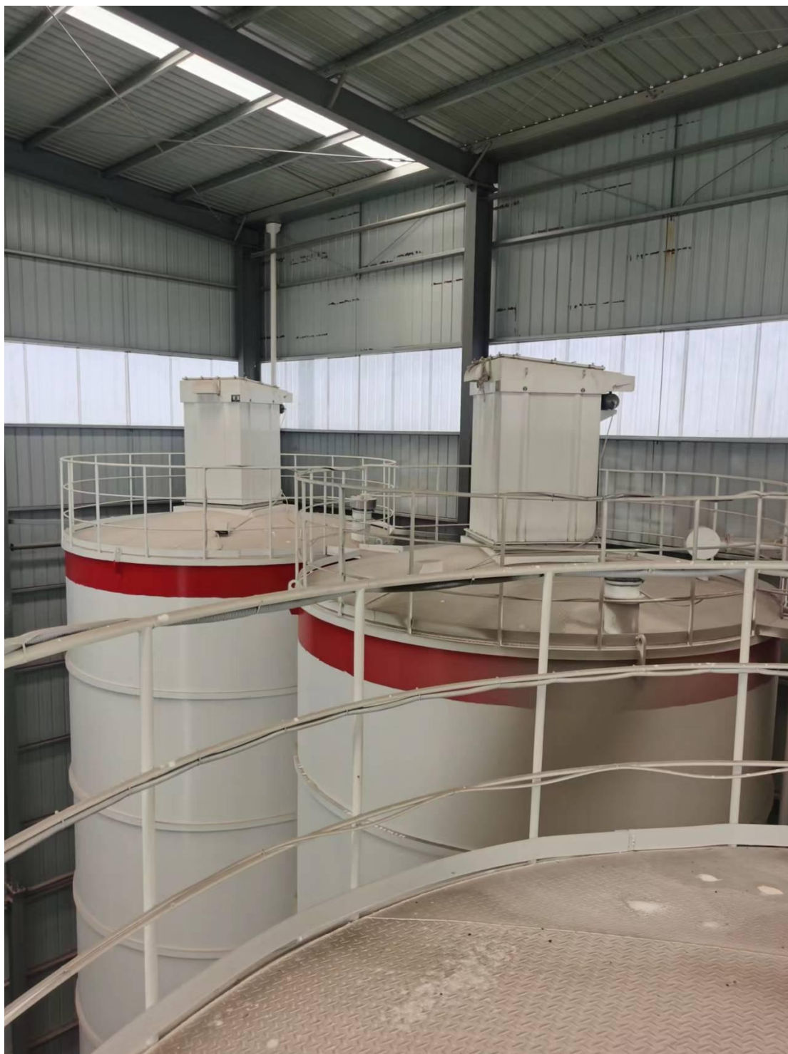
图 4-2 废气收集装置
