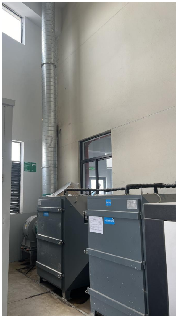
二级活性炭装置及 FQ1 排气筒
