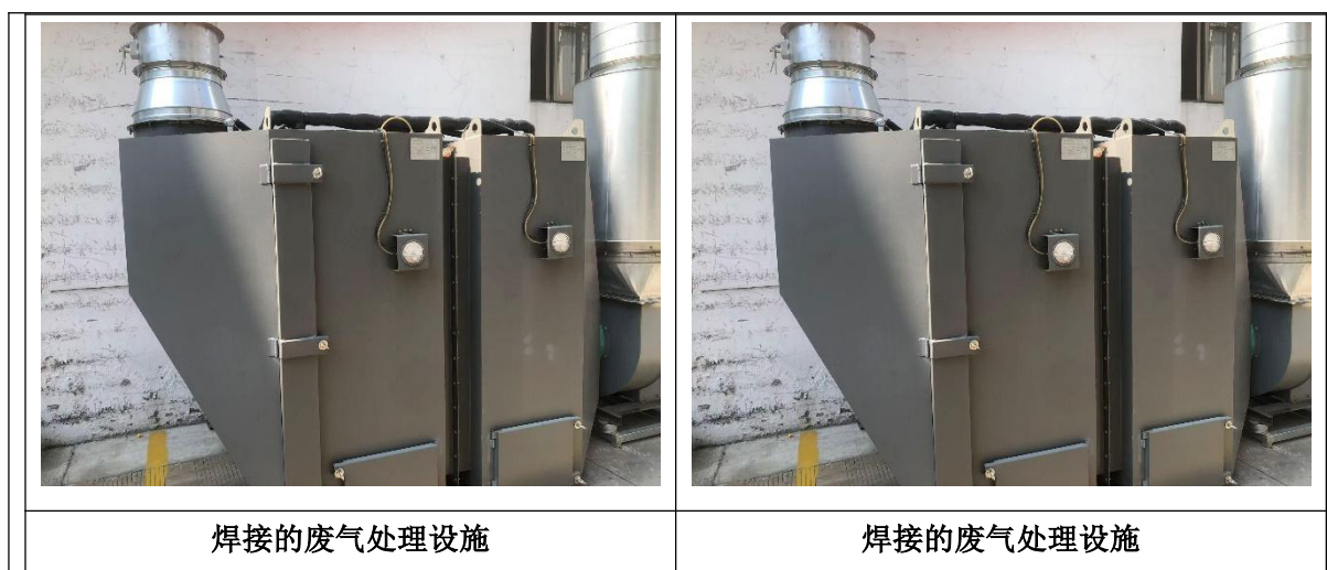
图 3-7 废气处理设施现场照片
