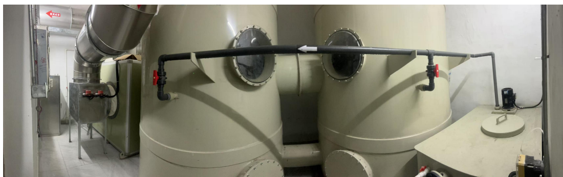
渗滤液处理设施植物液喷淋装置
