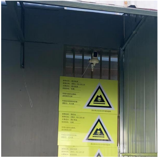
危废仓库内部摄像头
