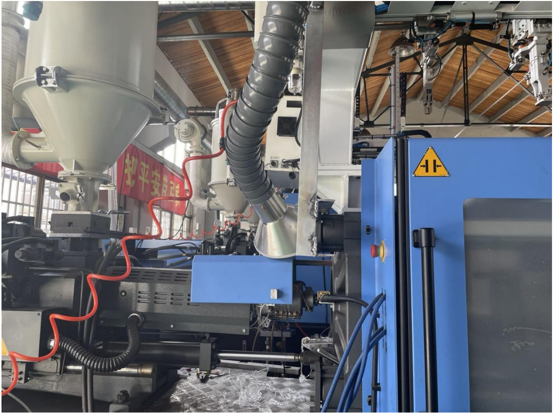
图 4-4 废气收集装置
