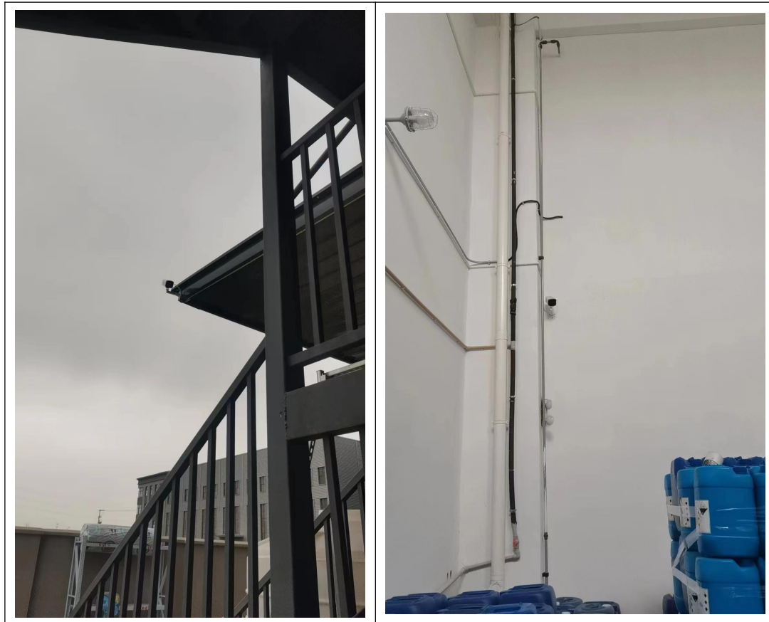
图 4-7 危废仓库内、外监控设备
