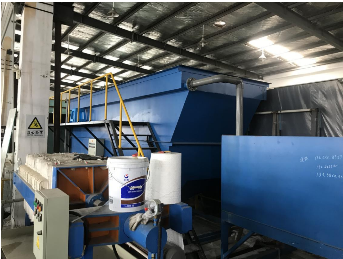
污水处理设施
