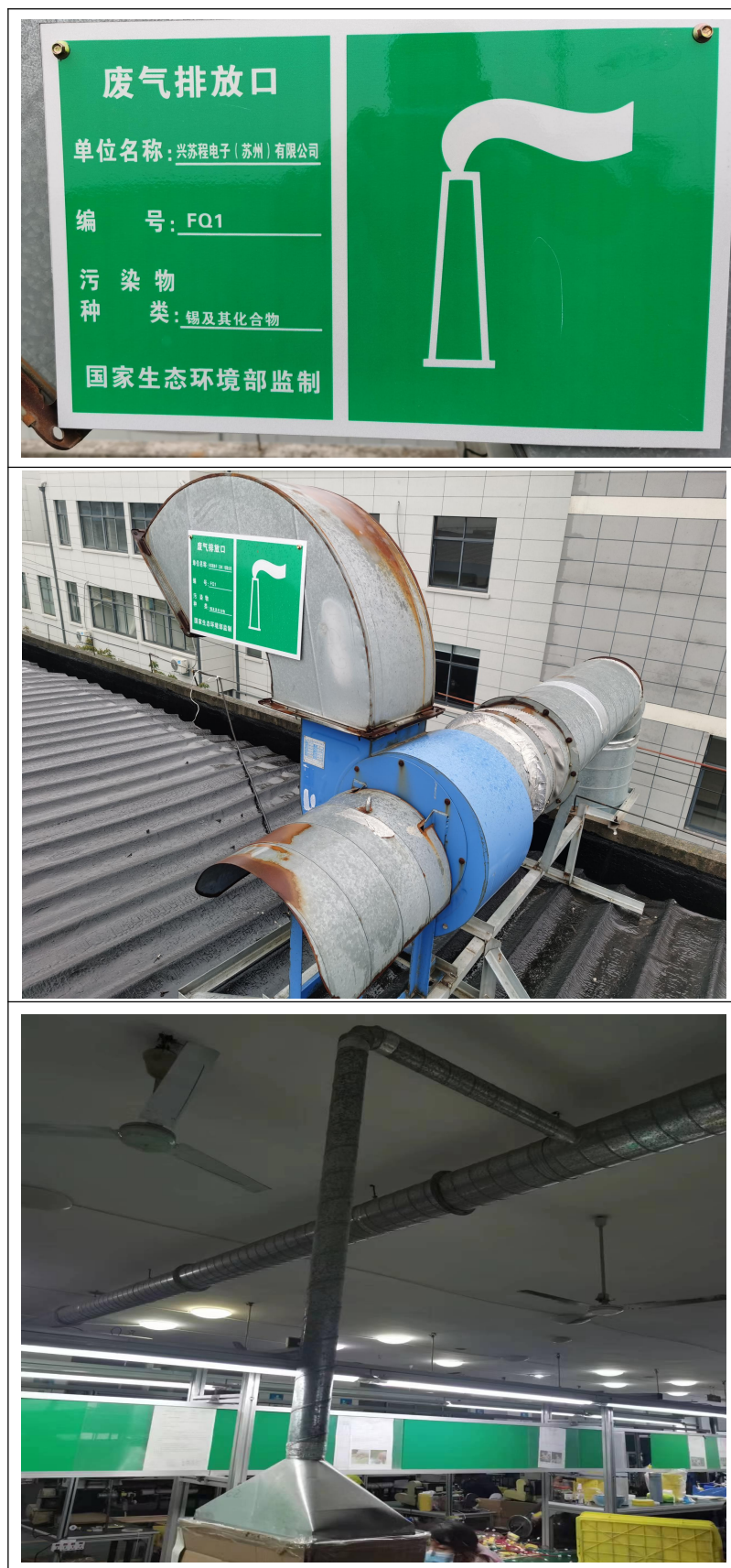
图 4-2 废气排放口标识标牌
