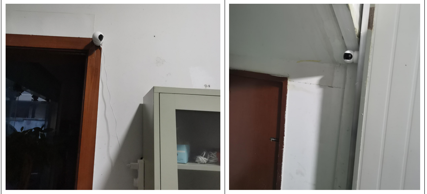
附图 4-6 危废仓库内、外监控设备
